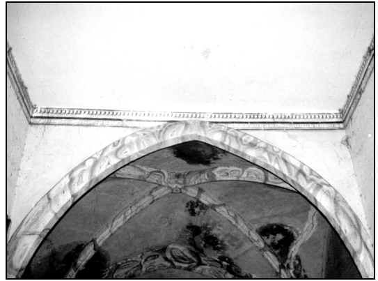
Faux alignement des clefs des arcs (photographie n° 23)
