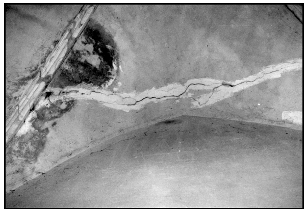
Fissure de la voûte du chœur côté sud (photographie n° 27)
